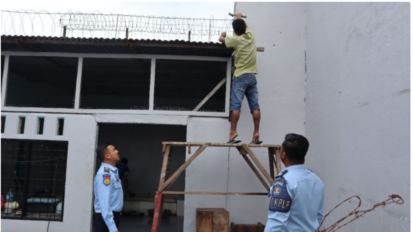
Pemasangan Kawat Silet Razor pada Lapas Tembilahan diawasi oleh dua orang Petugas
